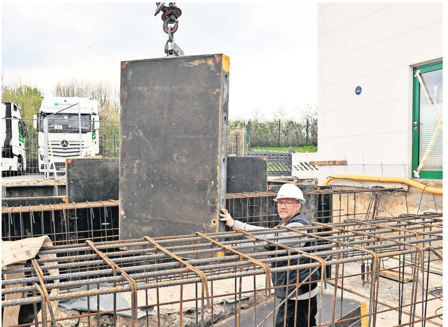
Polier Steffen Berg (52) von SZ-Bau arbeitet mit am Bau der Produktions- und Lagerhalle für den Büromöbelhersteller Palmberg in Schönberg. FOTOS: JÜRGEN LENZ
